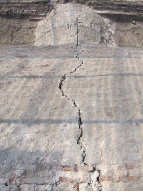
Picture 8. Cracks on the vault Resim 8. Tonoz çatlakları
