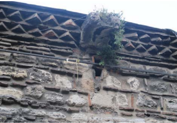
Picture 5. Damages before the repair works Resim 5. Onarım öncesi hasarlar
