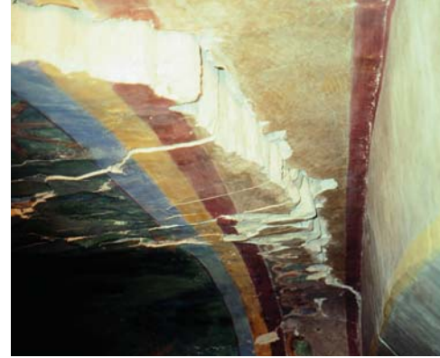
Picture 18. The Basilica of St. Francis in Assisi: Large cracks Resim 18. Assisi'deki St. Francis Bazilikası: Büyük çatlaklar
