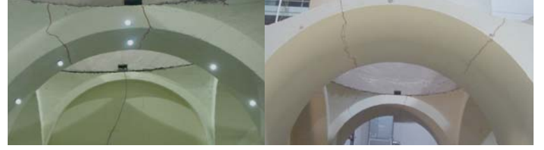
Picture 29. Phase 1: Cracks of central arch and lateral vaults Resim 29. 1. faz: merkezi kemer ve yanıl çatı kemerlerindeki çatlaklar
