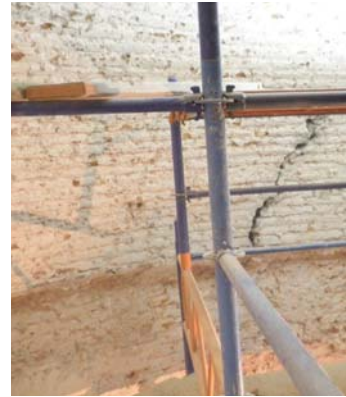
Picture 8. K8 dome crack detail (Beyazıt Mosque - 2013) Resim 8. K8 kubbesi çatlak detayı (Beyazıt Camii - 2013)
