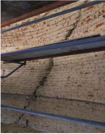
Picture 7. K1 dome crack detail – External view (2013) Resim 7. K1 kubbesi çatlak detayı - Dış görünüş (2013)
