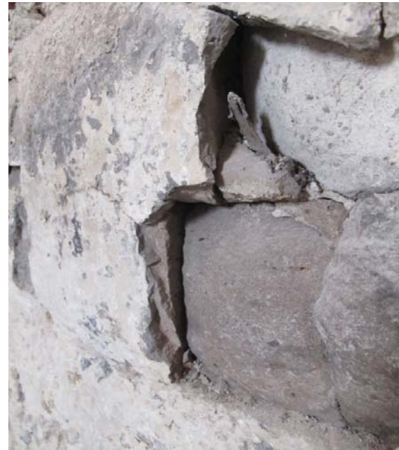
Picture 10. Damages on the stones Resim 10. Taş hasarları
