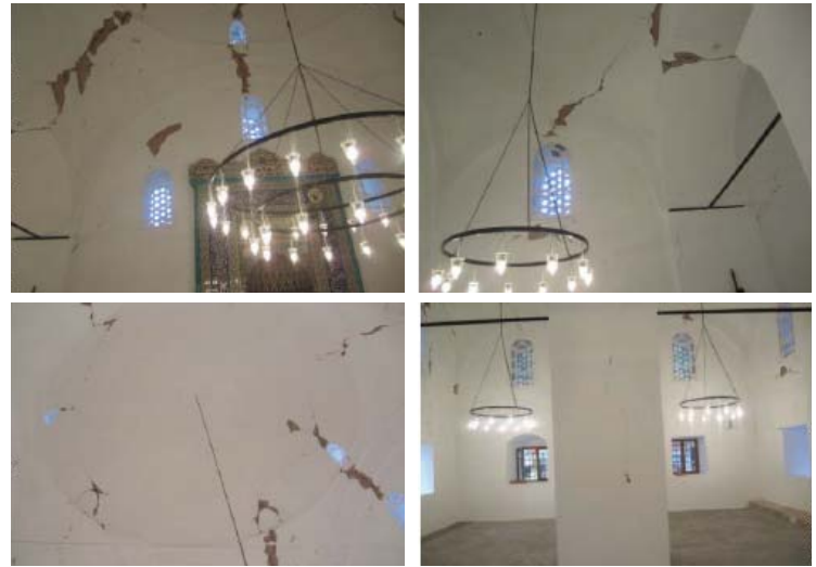
Picture 1. Damages Occurred in Nasuh Ağa Mosque Resim 1. Nasuh Ağa Camii'nde oluşan hasarlar
