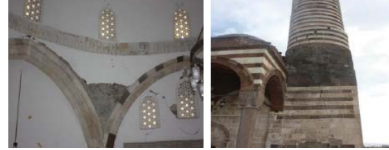
Picture 7. Damages occurred in Kaya Çelebi Mosque and its minaret Resim 7. Kaya Çelebi Camii ve minaresinde oluşan hasar
