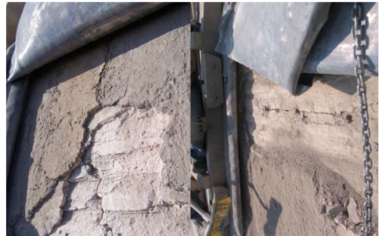
Picture 4-5. Outer cracks Resim 4-5. Dış çatlaklar
