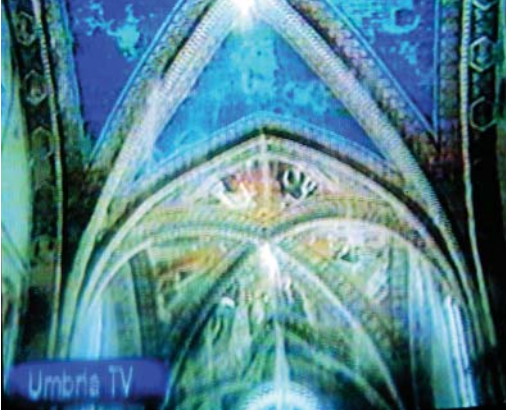
Picture 16. The Basilica of St. Francis in Assisi: Collapse of the two vaults Resim 16. Assisi'deki St. Francis Bazilikası: İki tonozun çöküşü
